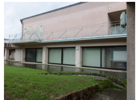
↑ホールに設置されたガラス窓
